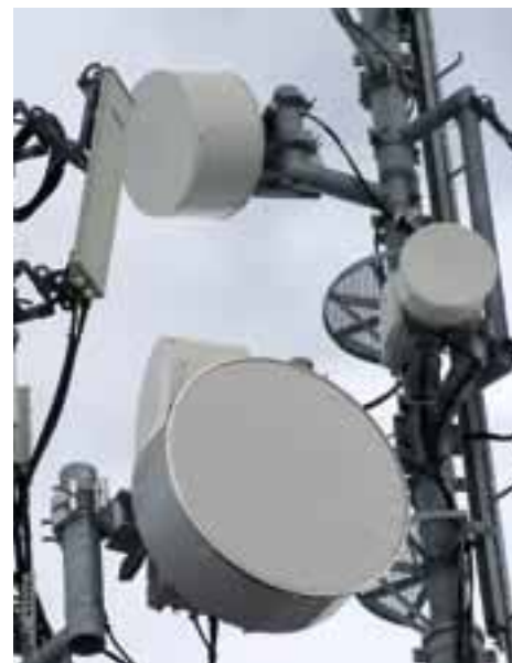
Diese Richtfunkantennen auf dem Jakobshorn GR verbinden Mobilfunk-Basisstationen über relativ kurze Distanzen mit einer Telefonzentrale.
